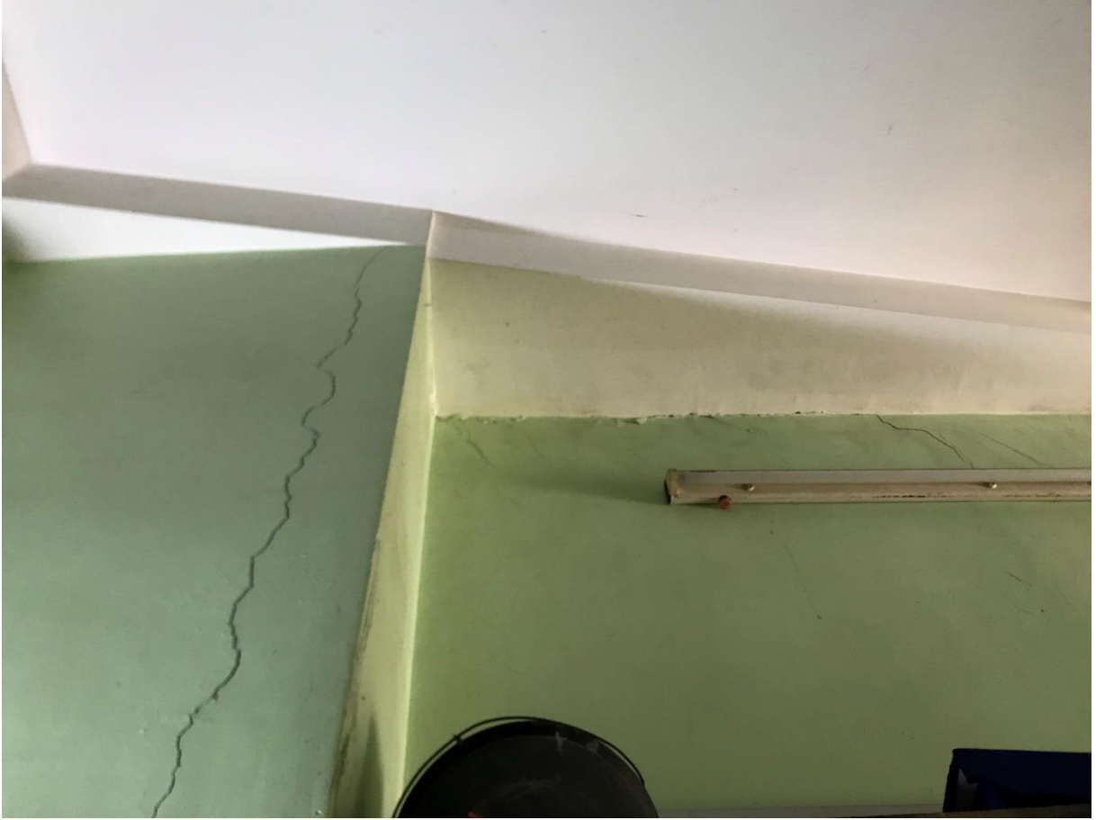
Tường Nứt thấm
